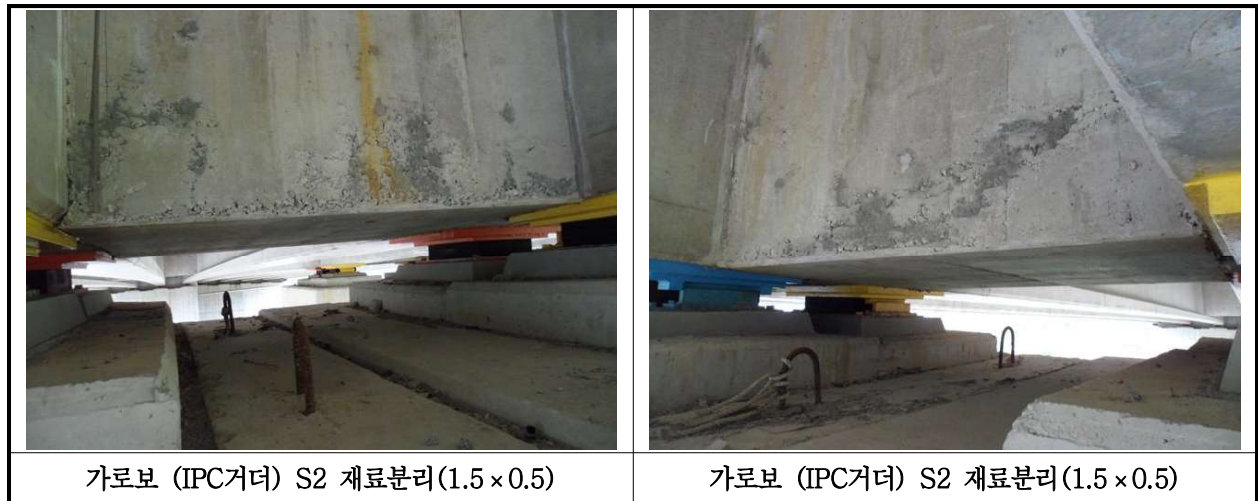
【사진 40.3.7】 가로보 손상현황
