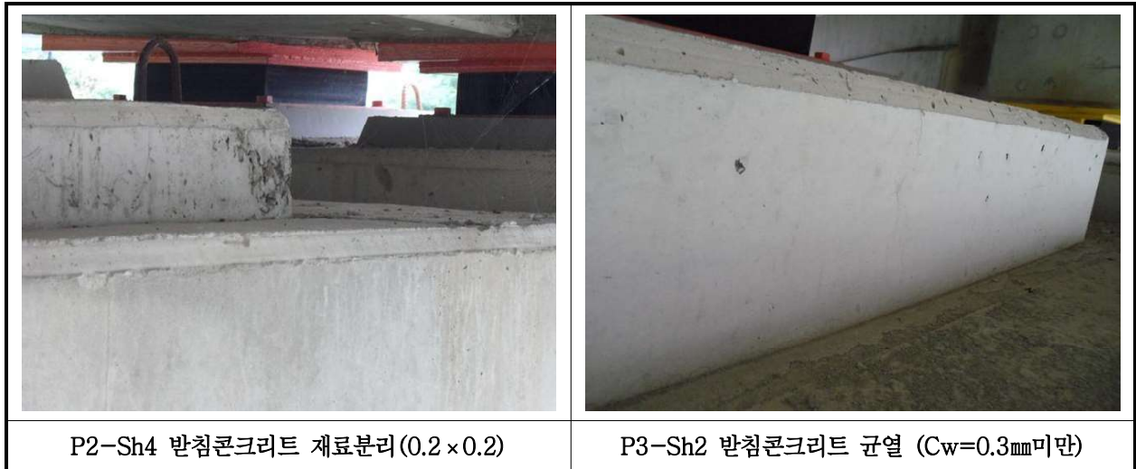
【사진 40.3.13】 교량받침 손상현황
