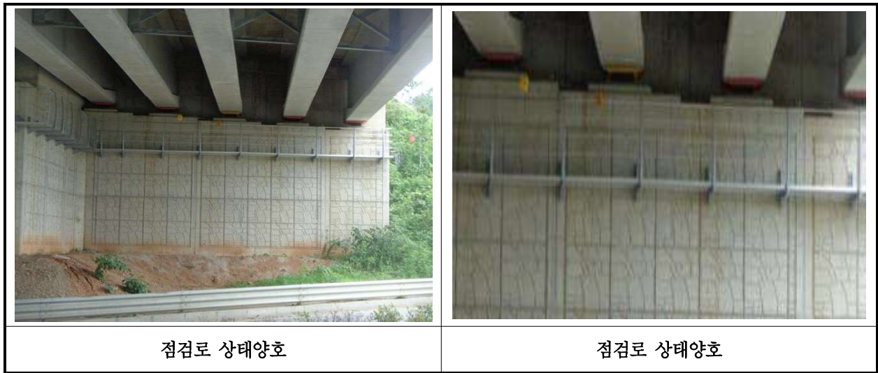
【사진 40.3.26】 교량 점검시설 손상현황
