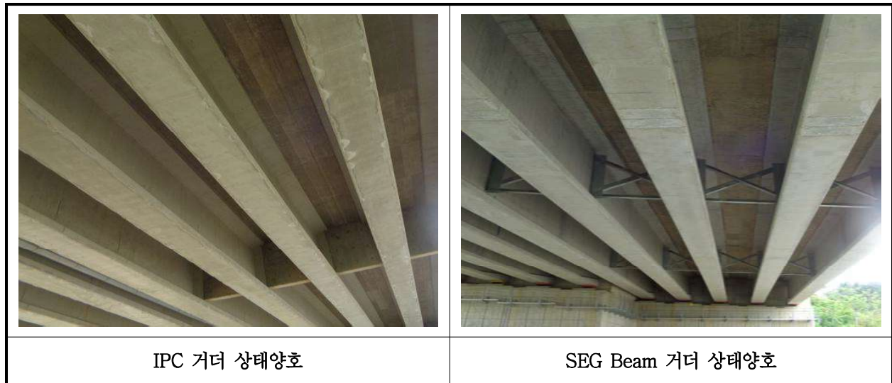
【사진 40.3.5】 거더 손상현황
